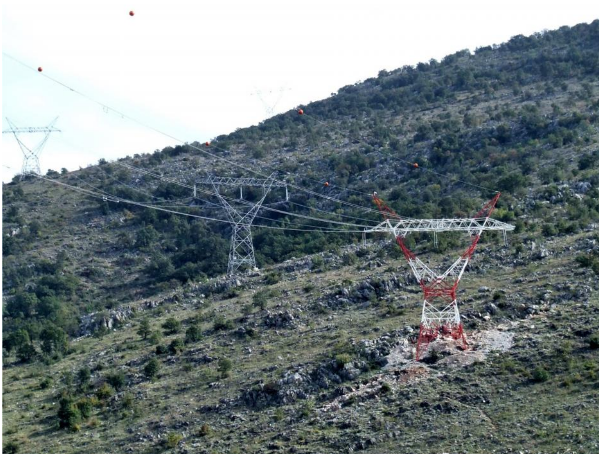
Slika 1. DV 400 kV Podgorica-Tirana
