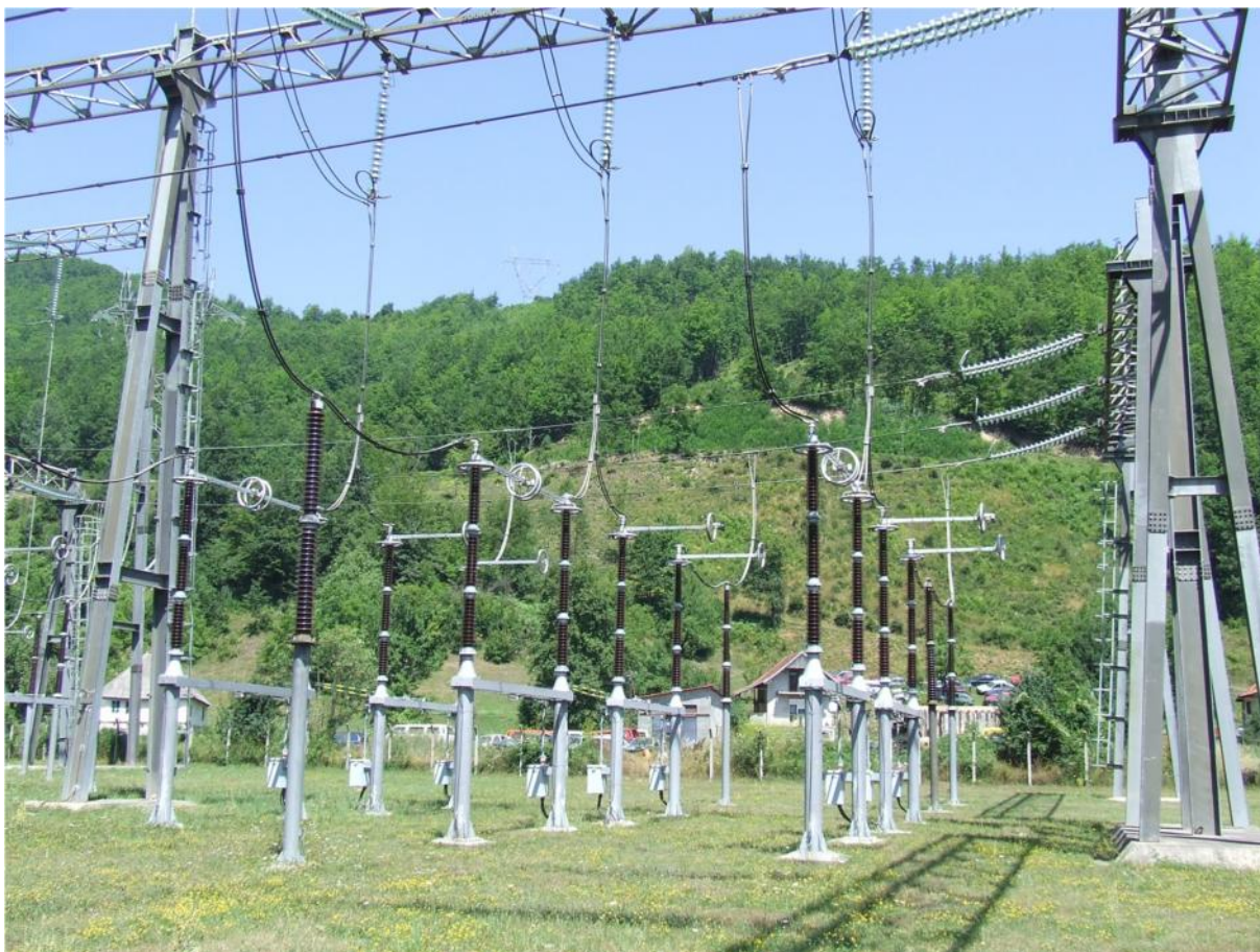
Slika 2. TS 400/110 kV Ribarevine
