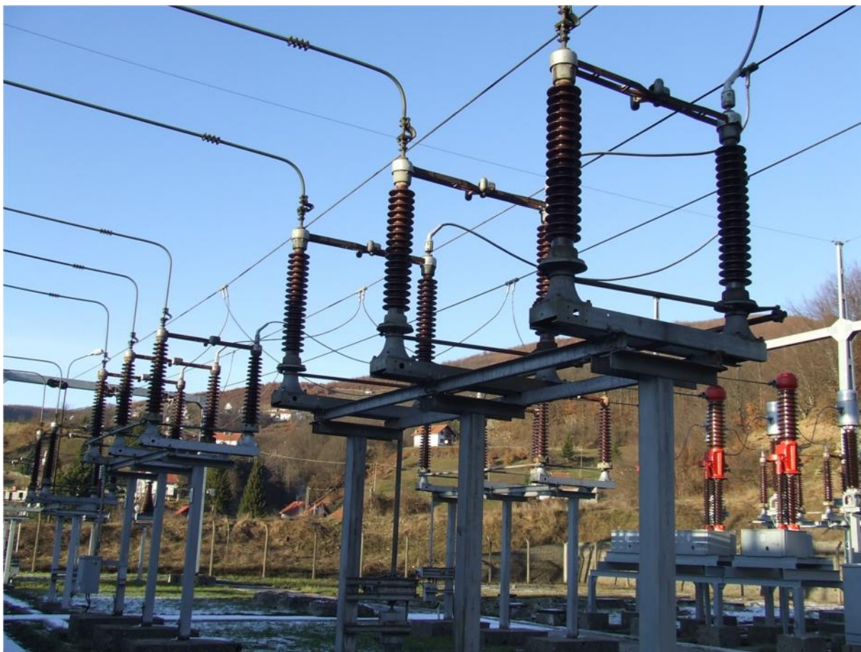
Slika 4. TS 220/110/35 kV Mojkovac
